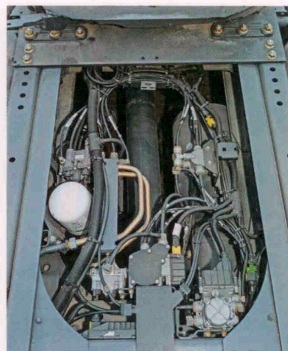
В лонжеронах рамы плотно уложена проводка, трубки и пневмоаппаратура
